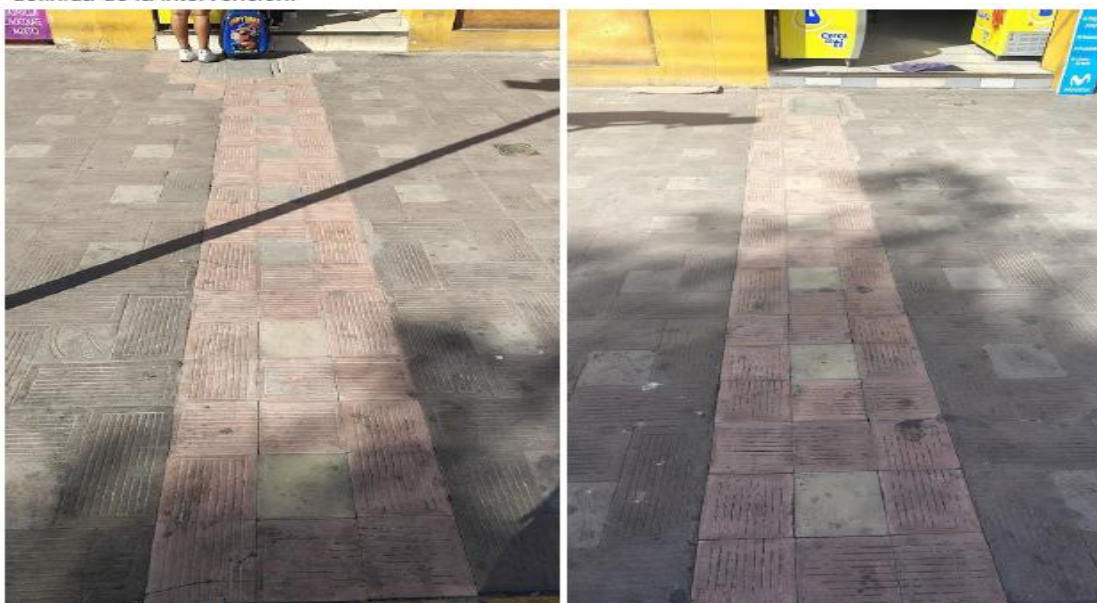
IMAGEN 13 – IMAGEN 14: Vista del onceavo y doceavo tramo en la vereda de la calle Lima, donde se observa un color y formato diferente a las losetas originales.
