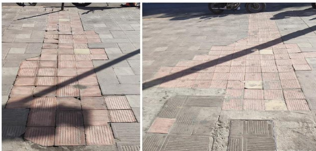
IMAGEN 11 – IMAGEN 12: Vista del noveno y décimo tramo en la vereda de la calle Lima, donde se observa un color diferente de losetas, así como piezas rotas producto de la mala instalación y sin forma definida de la intervención.
