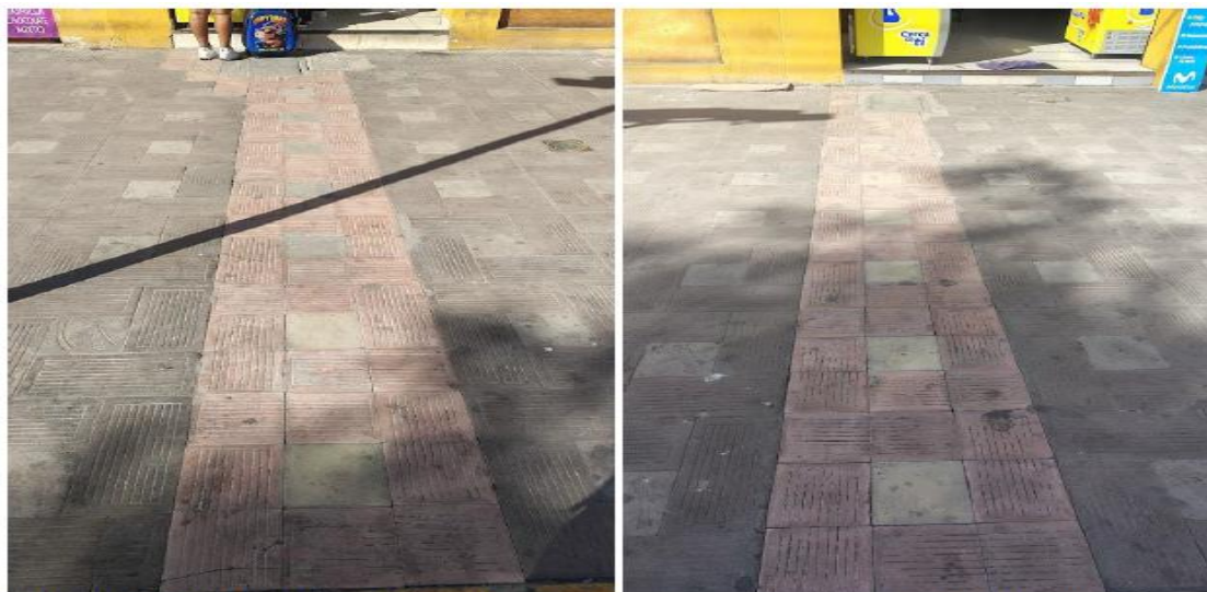
IMAGEN 13 – IMAGEN 14: Vista del onceavo y doceavo tramo en la vereda de la calle Lima, donde se observa un color y formato diferente a las losetas originales.
