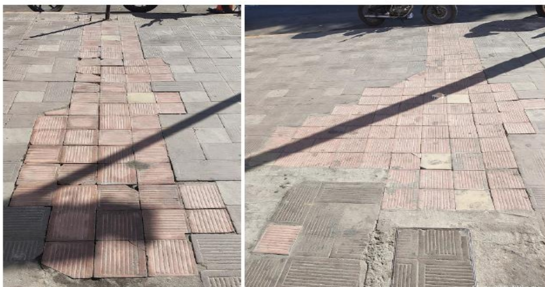
IMAGEN 11 – IMAGEN 12: Vista del noveno y décimo tramo en la vereda de la calle Lima, donde se observa un color diferente de losetas, así como piezas rotas producto de la mala instalación y sin forma definida de la intervención.
