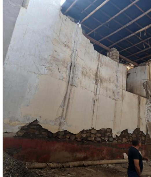
Sector afectado del muro del Evangelio
