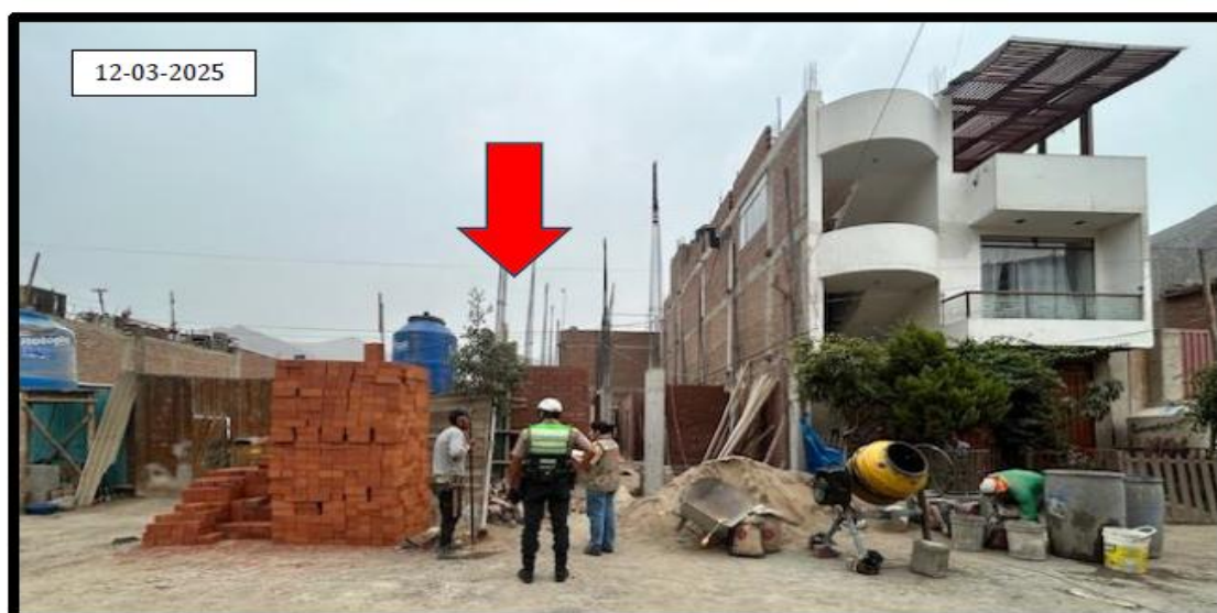
Imagen No 1: Zona Arqueológica Monumental Huaycán de Pariachi, Véase en la imagen el material de construcción ladrillos, arena, mezcladora para realizar la construcción de la edificación ubicado al interior del área intangible. Fuente: Dirección de Control y Supervisión de fecha 12 de marzo del 2025.
