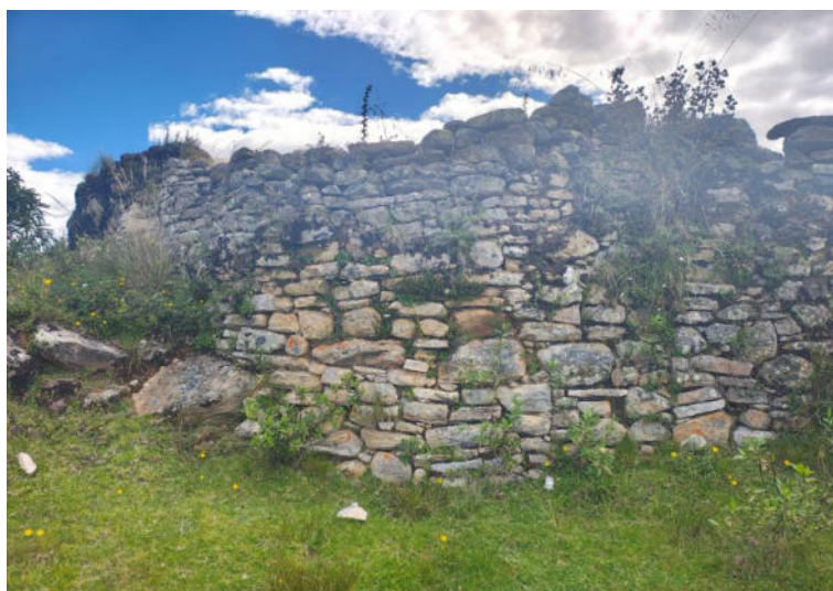
Imagen 03. Vista de maleza que se encuentra creciendo entre los intersticios de los muros.
