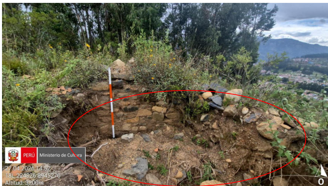
Imagen 01: se observa a detalle trabajos de huaqueo realizados en medio de los recintos arquitectónicos.
