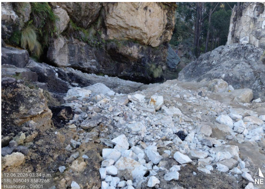
Fotografía 2. Vista de la calzada del camino rocoso afectado por la apertura de la trocha, cerca del polígono de Paturpampa.
