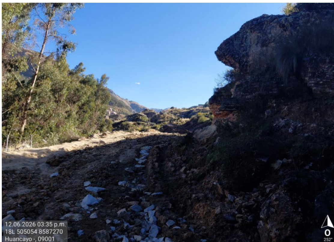
Fotografía 3. Vista de la calzada del camino en área rocosa y de tierra afectado por la apertura de la trocha, cerca del polígono de Paturpampa.
