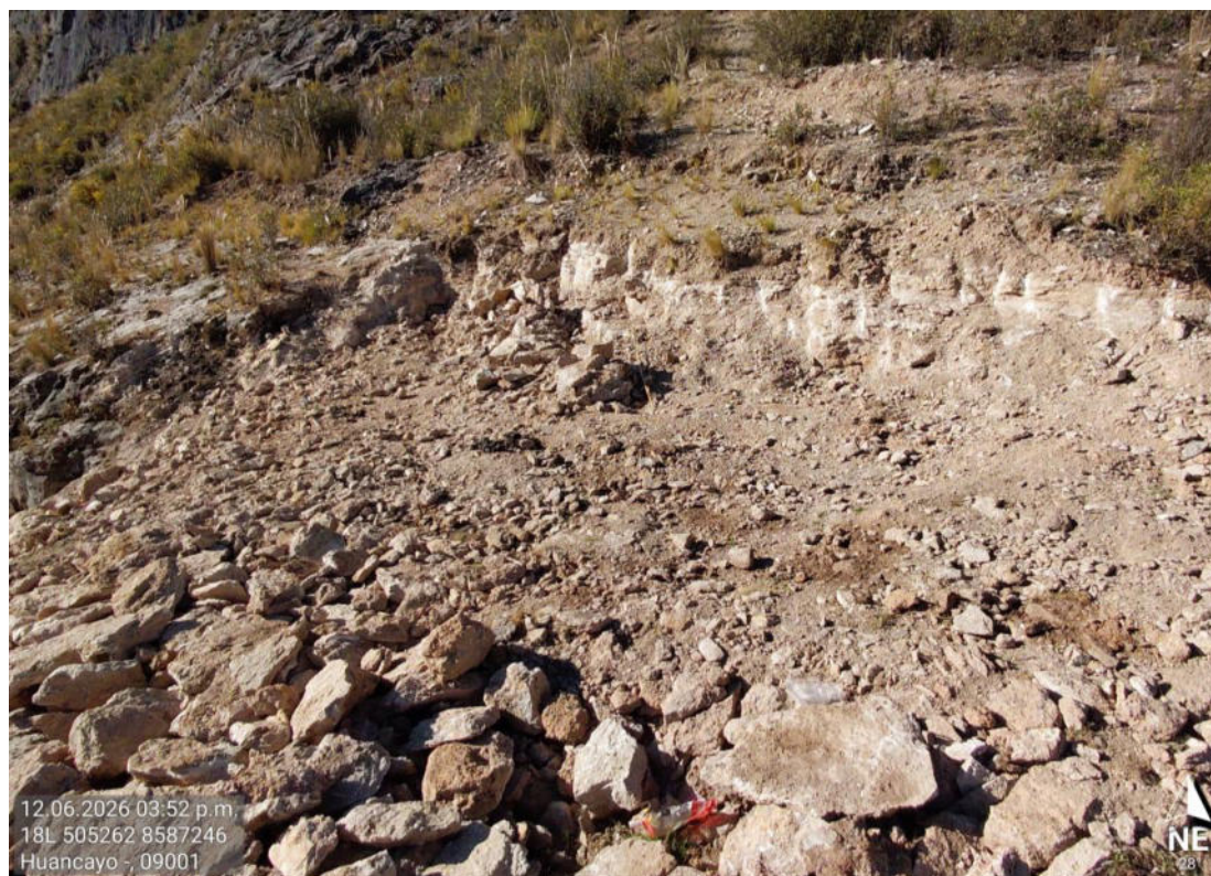
Fotografía 5. Excavación con maquinaria pesada en el lado este del camino prehispánico, como presunto intento de aperturar una trocha carrozable.
