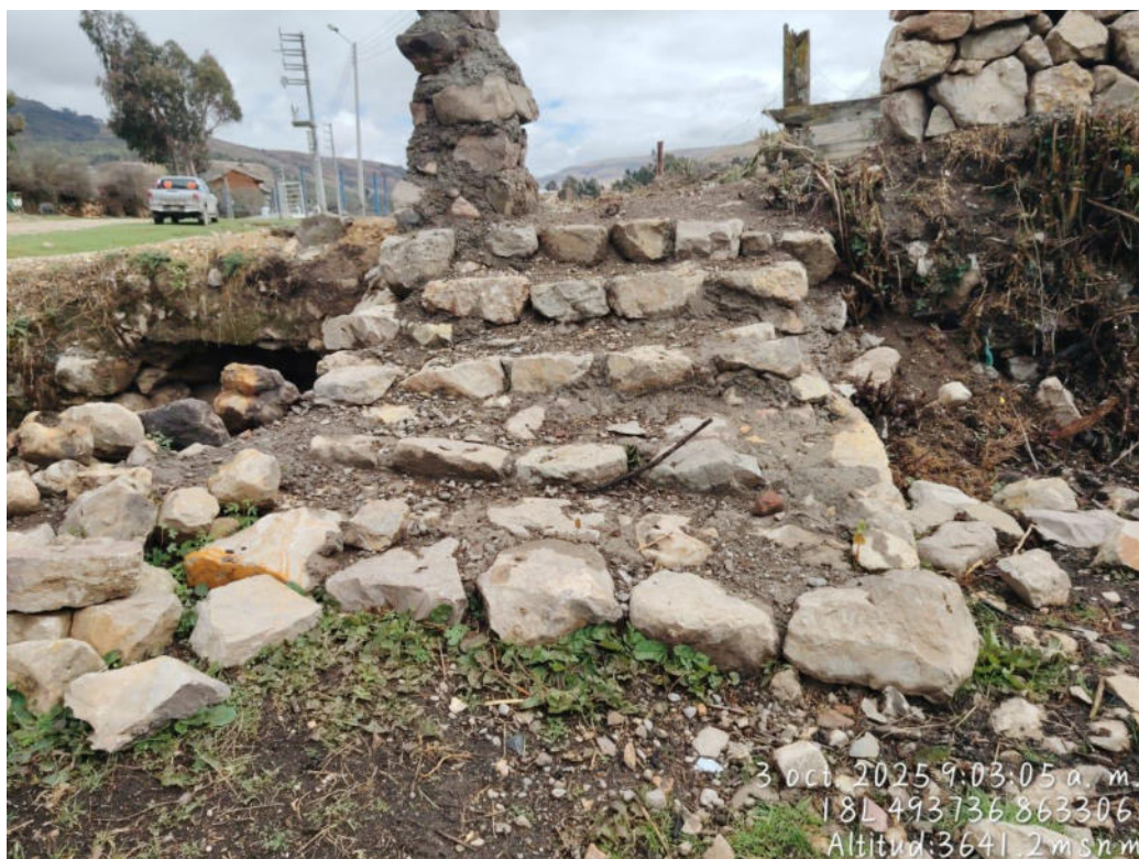
Fotografía 4. Vista a detalle de una escalinata con piedra y cemento colocado al interior del sitio arqueológico de Tambomachay sector B que genera afectación al monumento.
