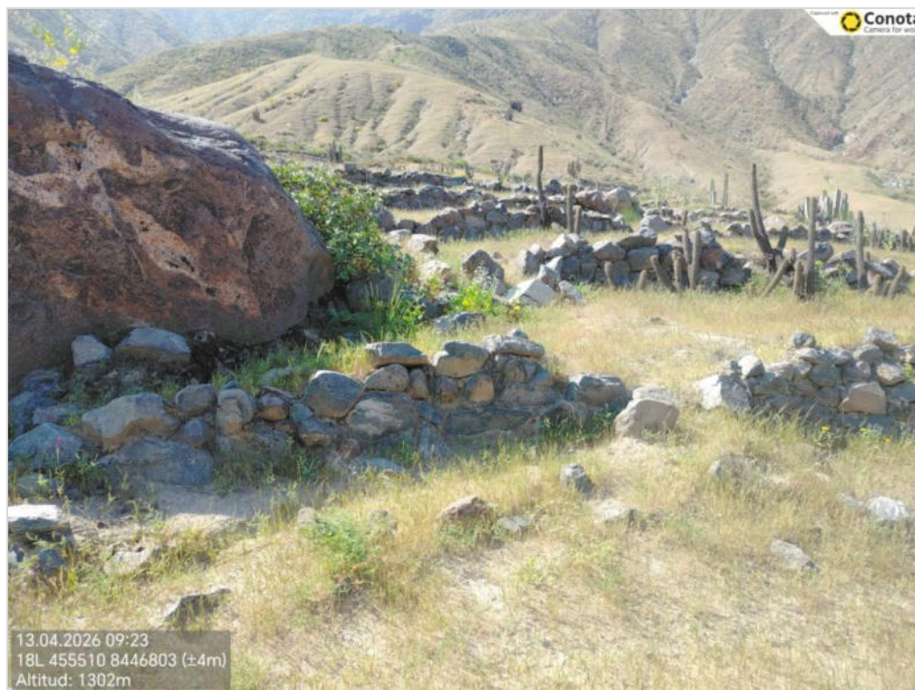
Foto 11. Se observa la afectación de algunas secciones de las andenerías.
