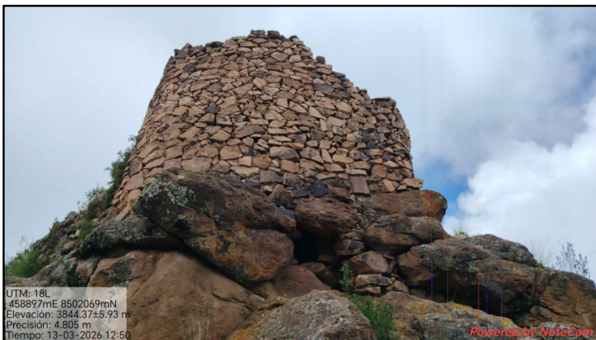
Imagen N° 08: Vista a detalle de una de las chullpas, evidenciamos que presenta un pequeño acceso en la parte inferior; este se encuentra en deterioro.
