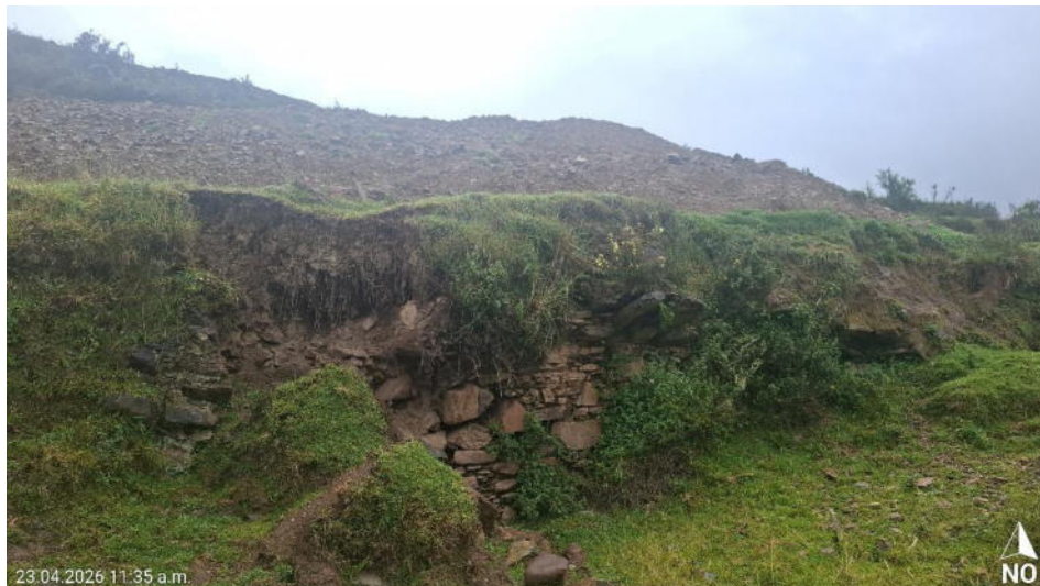
Fotografía 11. Vista de la arquitectura prehispánica que ha sido afectado desde la parte alta del sitio arqueológico Tambomarka.
