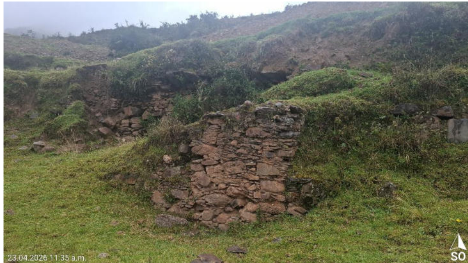
Fotografía 10. Vista de la arquitectura prehispánica que ha sido afectado desde la parte alta del sitio arqueológico Tambomarka.
