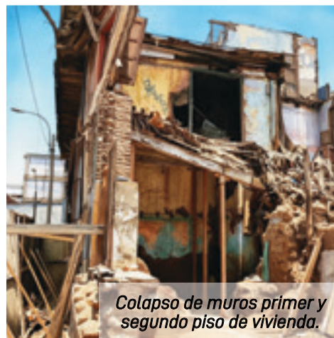
Muros de vivienda en peligro de colapso.
