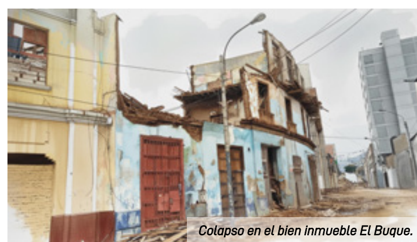
Colapso de muros primer y segundo piso de vivienda.
