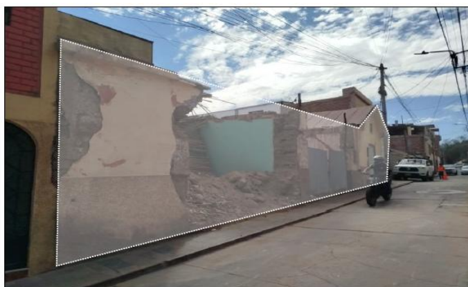
Imagen N.º 4: Imagen correspondiente a la inspección del 18.05.25, donde se advierte la alteración de la Z.M de Moquegua, por los trabajos efectuados en la fachada del inmueble en cuestión
