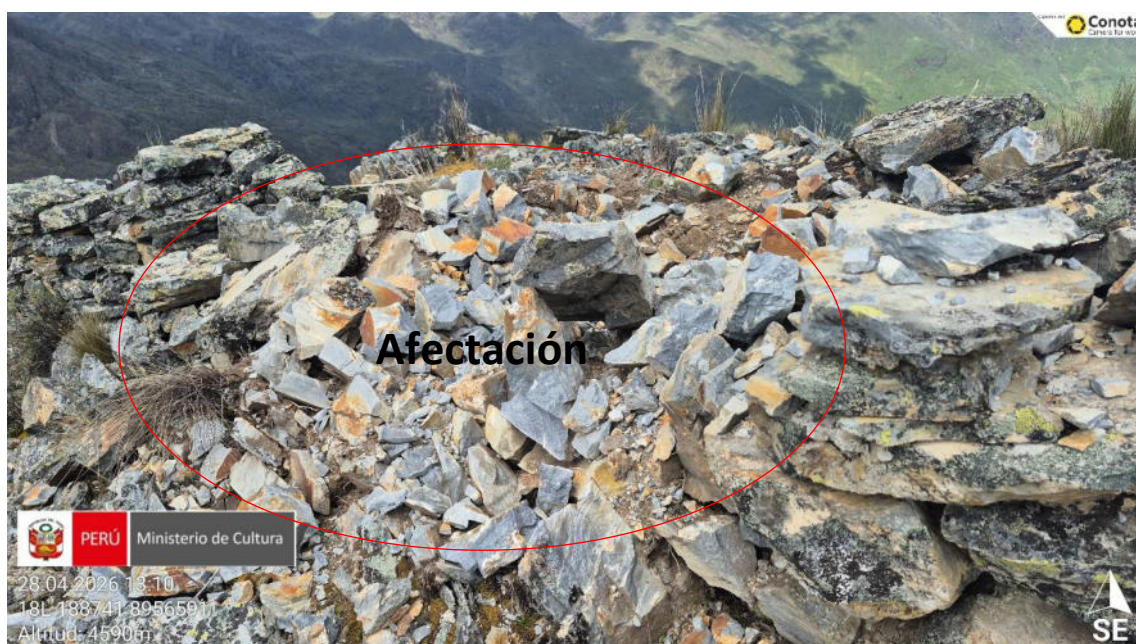
Imagen 03: vista a detalle de afectación directo de muros de piedra producto
