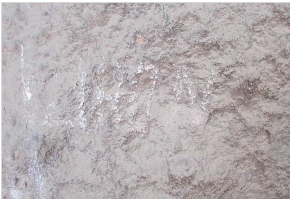
Foto 09. Vista en detalle de la afectación por trazo de tiza.
