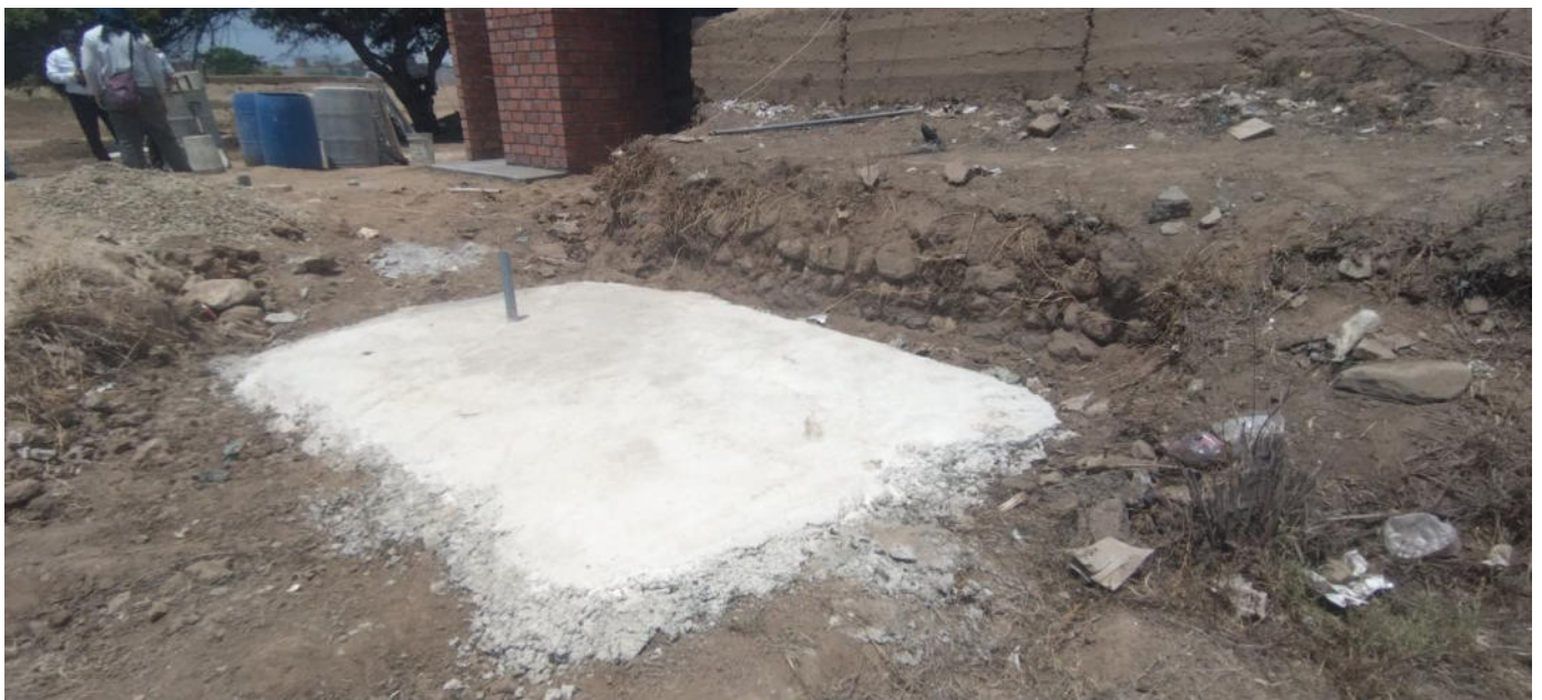
Fig. Vista panorámica de las bases de un muro arqueológico, el mismo que se encuentra colindante (fuera) del polígono de intangibilidad del "Sitio N° 2"; donde a su vez se observa colindante al mismo el vaciado de cemento en un área excavada, la que de proseguir actividades no autorizadas dejan en peligro inminente de desaparecer dichas evidencias.
