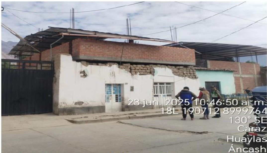
Fotografía 2. Vivienda ubicada en el CA. Cruz Viva Nro. 187, Caraz. Posterior a su demolición. Distingase la vivienda de material noble en los frentes este - sur, nótese, además, la presencia parcial de muro de adobe.
