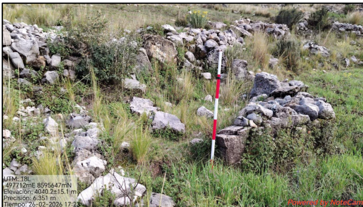
Imagen N° 08: Vista de una de las estructuras cuadrangulares empleadas para la ocupación humana, se encuentra en deterioro, se requiere de su preservación.
