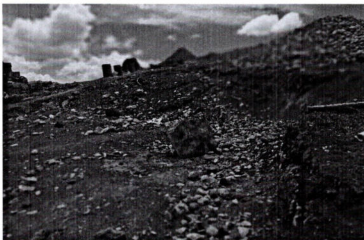
Imagen 7. Vista de la remoción de tierra con maquinaria pesada un área de 40m 2 ubicado fuera del polígono del sitio arqueológico. (inspección 13/02/2026)
