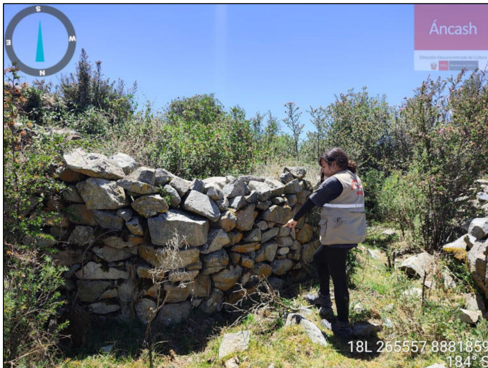
Imagen 04: vista a detalle de muros elaborados con técnica de pircado de piedra labrada.
