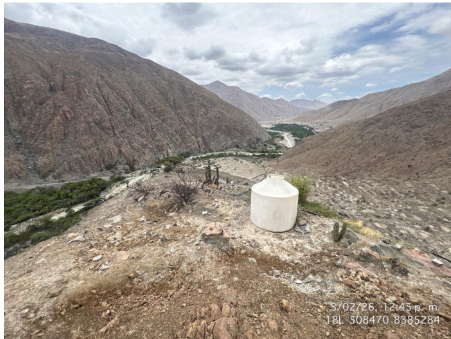
Fig. 05: Vista en detalle de las afectaciones por instalaciones de tanques y manguera.
