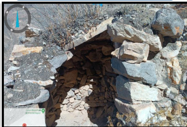
Foto N° 06, que muestra una estructura funeraria abovedada en regular estado de conservación, verificando la afectación del mismo.
