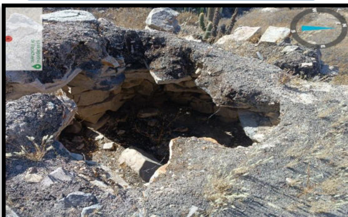
Foto N° 04, que muestra una vista desde la parte superior de una estructura funeraria el que se encuentra waqueada.
