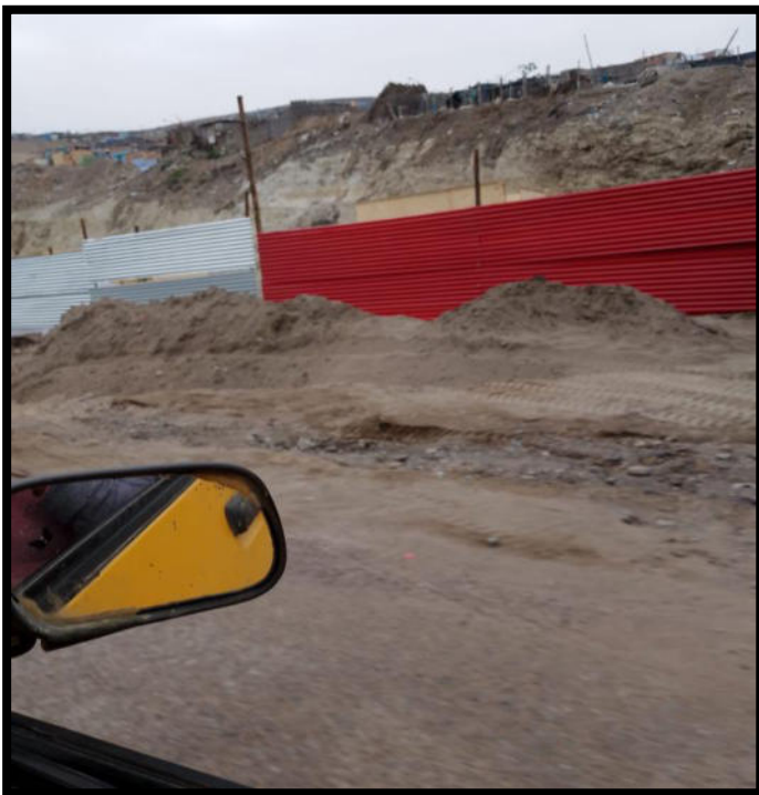
Foto N° 01: imagen fotográfica en el que se puede apreciar la excavación y remoción de suelos para viviendas contemporáneas (ref. vistas fotográficas de Whatsapp).
