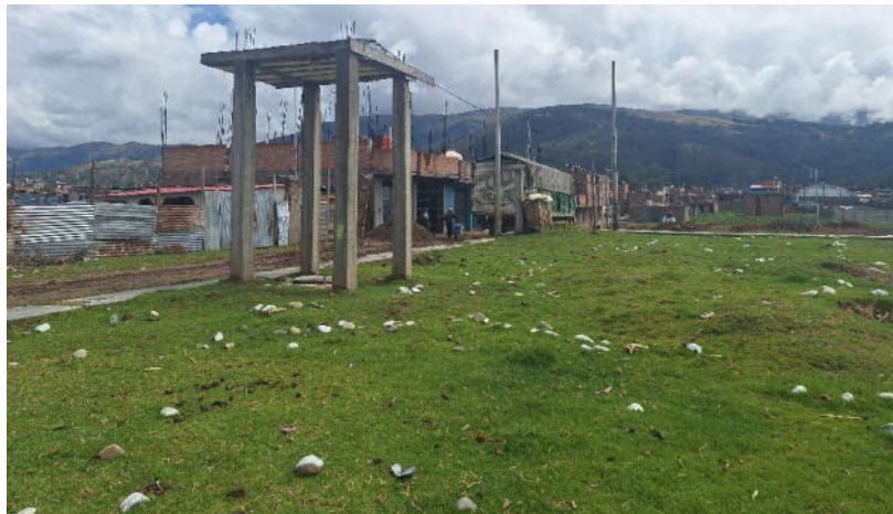
Foto 1. Vista de la construcción de viviendas y estructuras en concreto armado al interior del polígono de delimitación de Patan coto sector 1.
