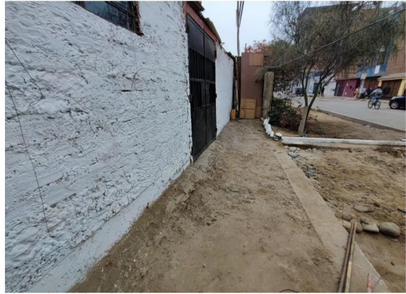
Foto 7. Zona Arqueológica Garagay. Vista tomada durante la inspección inopinada de fecha 22 de julio del 2025, donde se observa que el muro ya fue construido en su totalidad a pesar de la exhortación de paralización.
