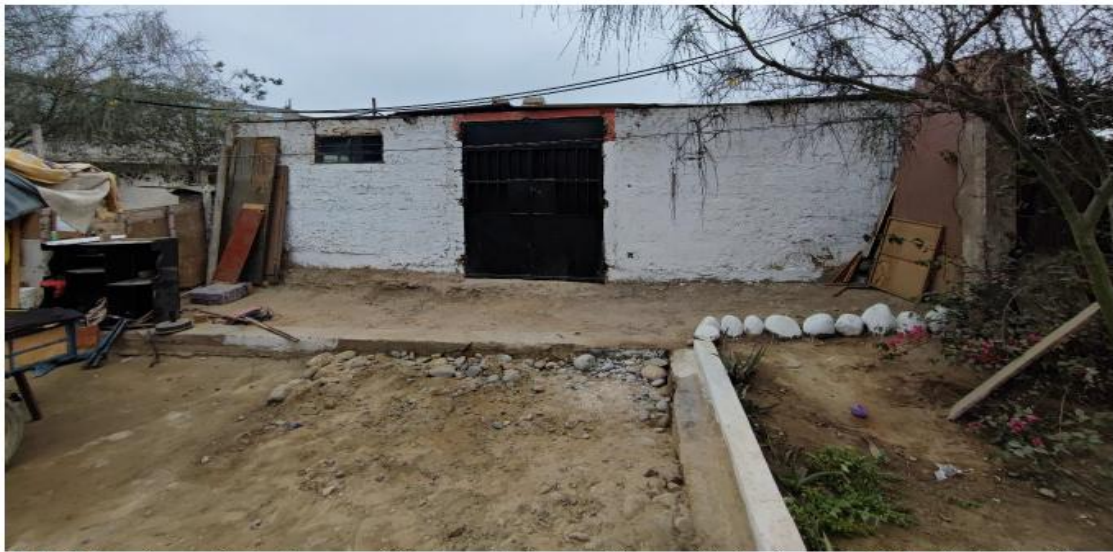
Foto 8. Zona Arqueológica Garagay. Vista tomada durante la inspección inopinada de fecha 22 de julio del 2025, donde se observa que el muro ya fue construido en su totalidad y se ha instalado un portón de metal para ingresar al comedor popular.
