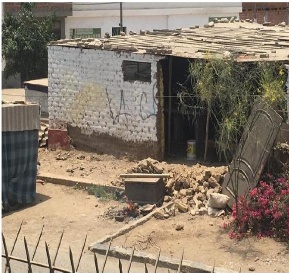
Foto 2. Zona Arqueológica Garagay. Imagen proporcionada mediante la denuncia de fecha 19 de enero del 2022 (D0056-22), donde se observa que el muro de adobe del lado sur del comedor popular 12 de agosto ya se encuentra en proceso de desmontaje.
