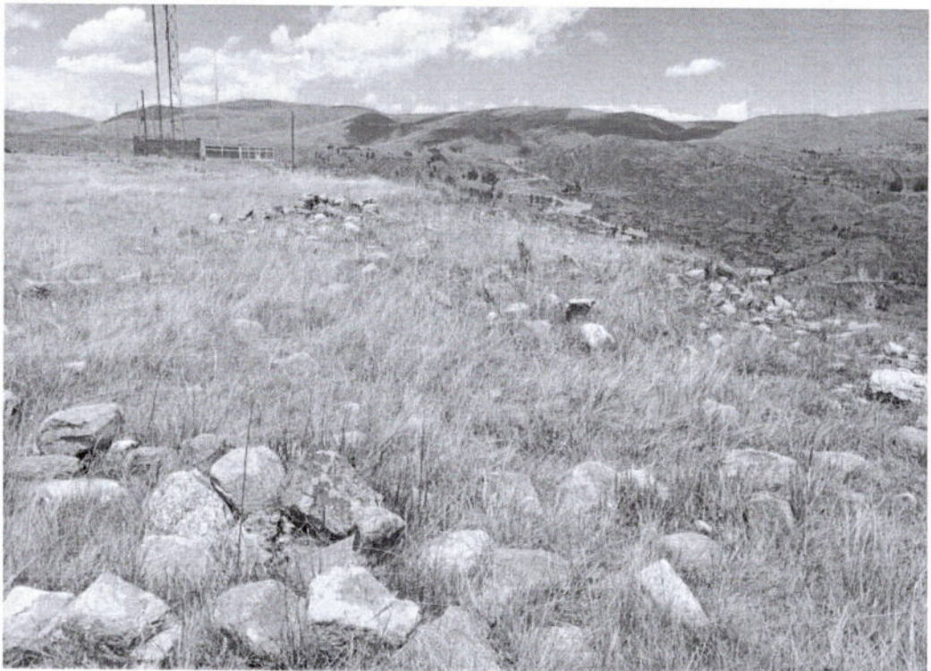
Imagen 9. Vista de colapso de muros de las colcas en el sitio arqueológico de Llullupata (inspección 13-11-2025)
