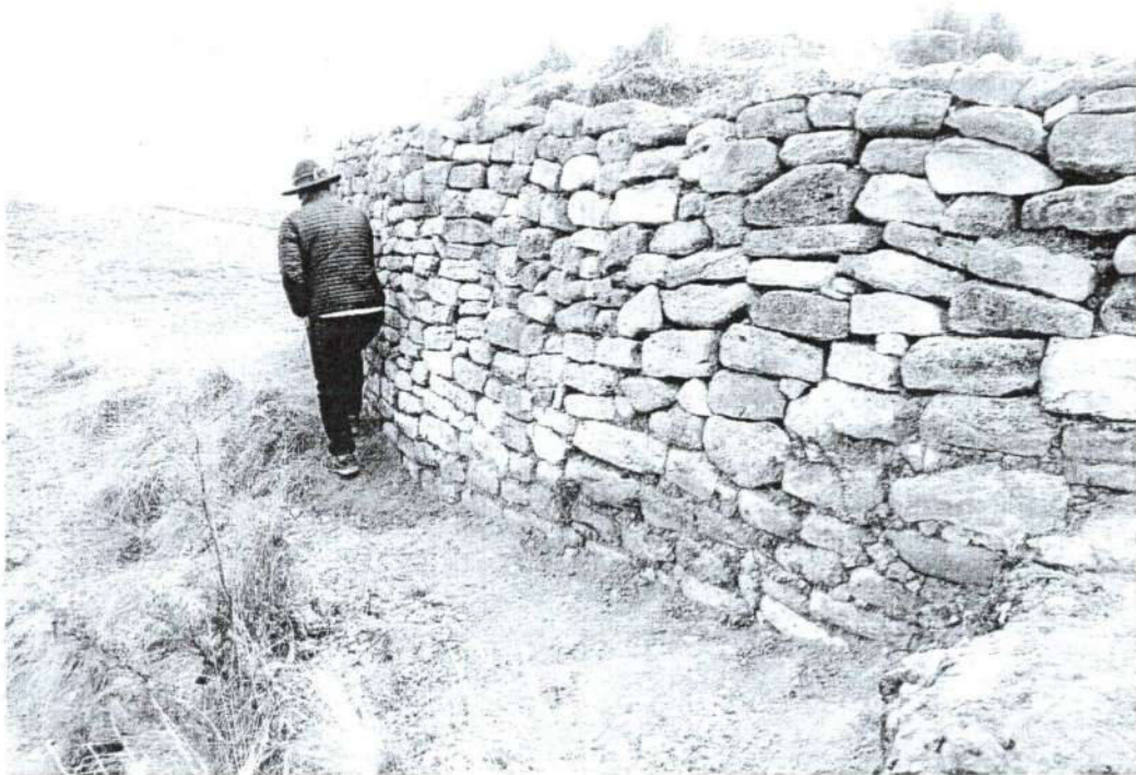
Foto.10: Vista de la estructura, forma semicircular donde se ha realizado limpieza y
