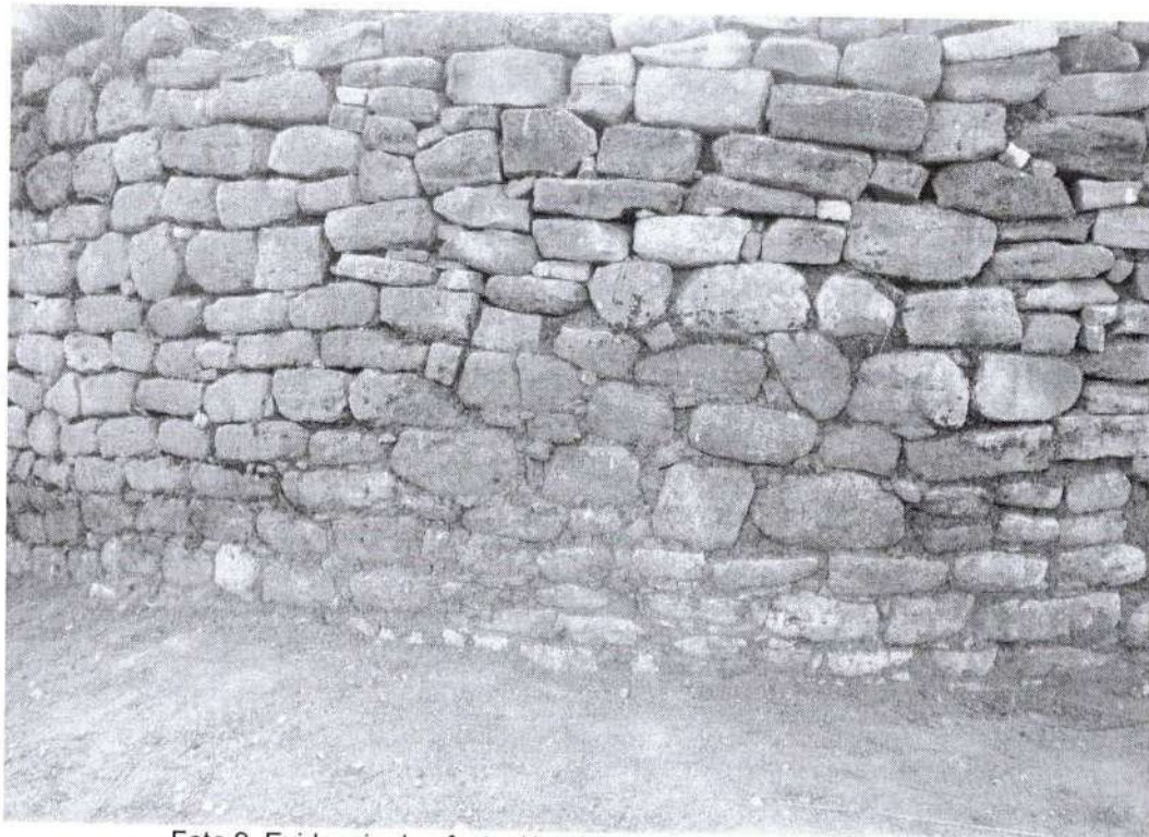
Foto 9. Evidencia de afectación al muro (inspección: 13/11/2025).
