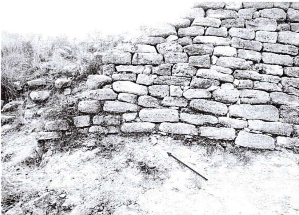
Foto.12: Vista de la estructura forma semicircular donde se ha realizado limpieza y se pone en riesgo la estabilidad del muro. (inspección técnica 20/08/2024).
