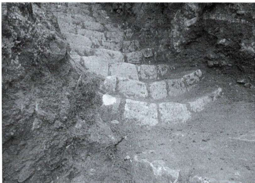
Foto 3. Vista en detalle de fractura de piedra parte de la escalera, causado por realizar la remoción de tierra por los pobladores de Palaco. (inspección 13/11/2025)
