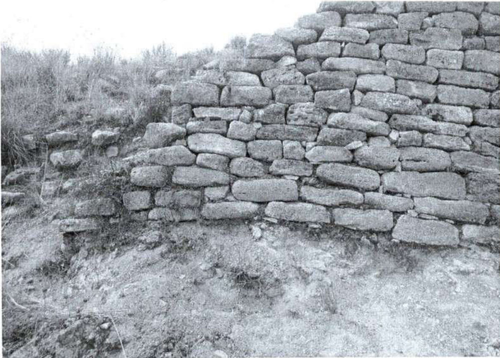
Foto 10. Vista donde se evidencia que la base del muro ha sido debilitado a causa de remoción de tierra (inspección: 13/11/2025).
