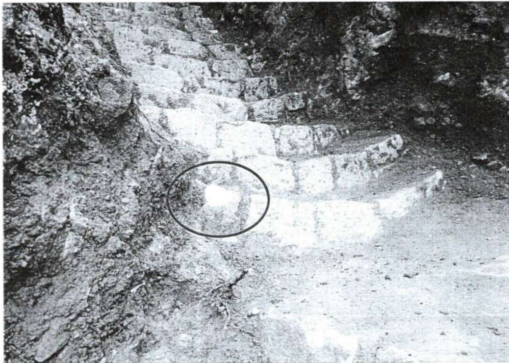
Foto.2: Vista de la escalinata excavado sin autorización del ministerio de cultura en la cual se evidencia la fractura en la piedra de la escalinata. (inspección técnica 20/08/2024).
