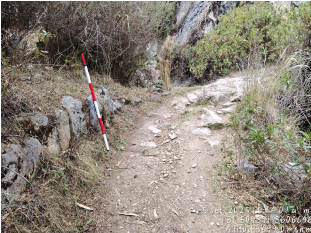
fotografía 5 vista en detalle del muro de contención que esta construida a base de piedras trabajas, estos muros eran esenciales en las laderas empinadas y terrenos inestables, en donde servían para sostener la tierra, creando una plataforma horizontal o aterrazada para el camino.
