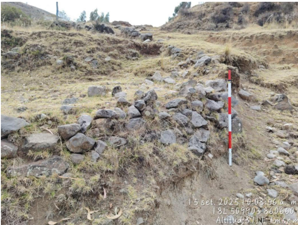
fotografía 3 vista en detalle del muro de contención que se observa en al costado del Camino Prehispánico.
