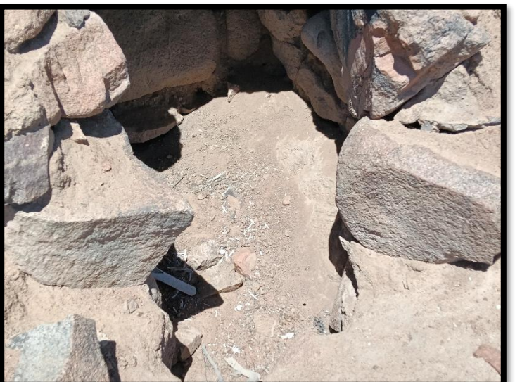
Foto N° 14: en el que se visualiza que una estructura arquitectónica correspondiente a una chullpa fue afectada por acciones antrópicas (waqueo).
