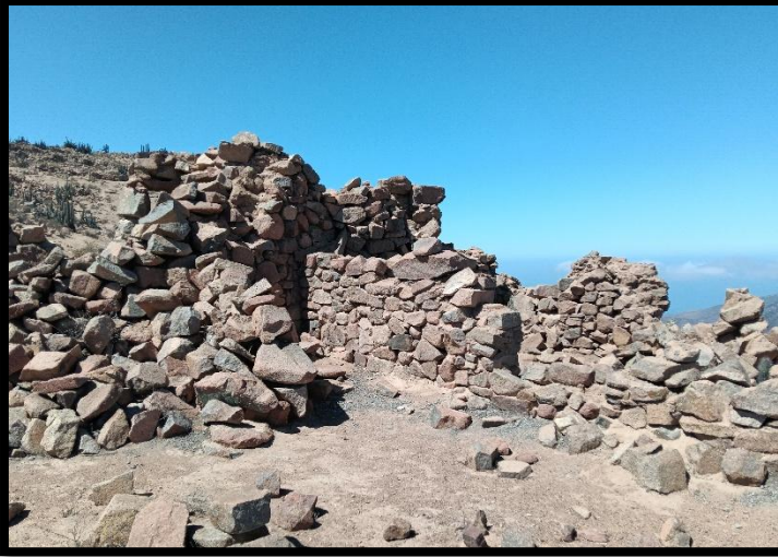
Foto N° 03: en el que se visualiza una estructura arquitectónica de data prehispánica en mal estado de conservación producto del colapso de sus paramentos.
