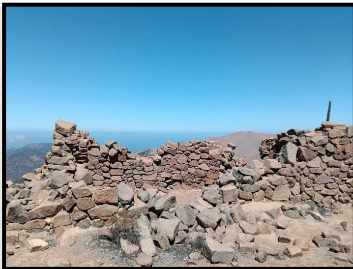
Foto N° 02: en el que se visualiza una estructura arquitectónica de planta cuadrangular, el cual colapso en al interior del mismo
