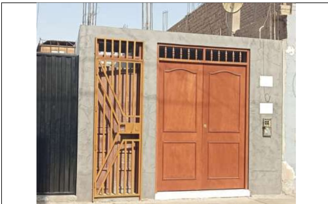
FUENTE: Inspección ocular de fecha 06/12/2023.
