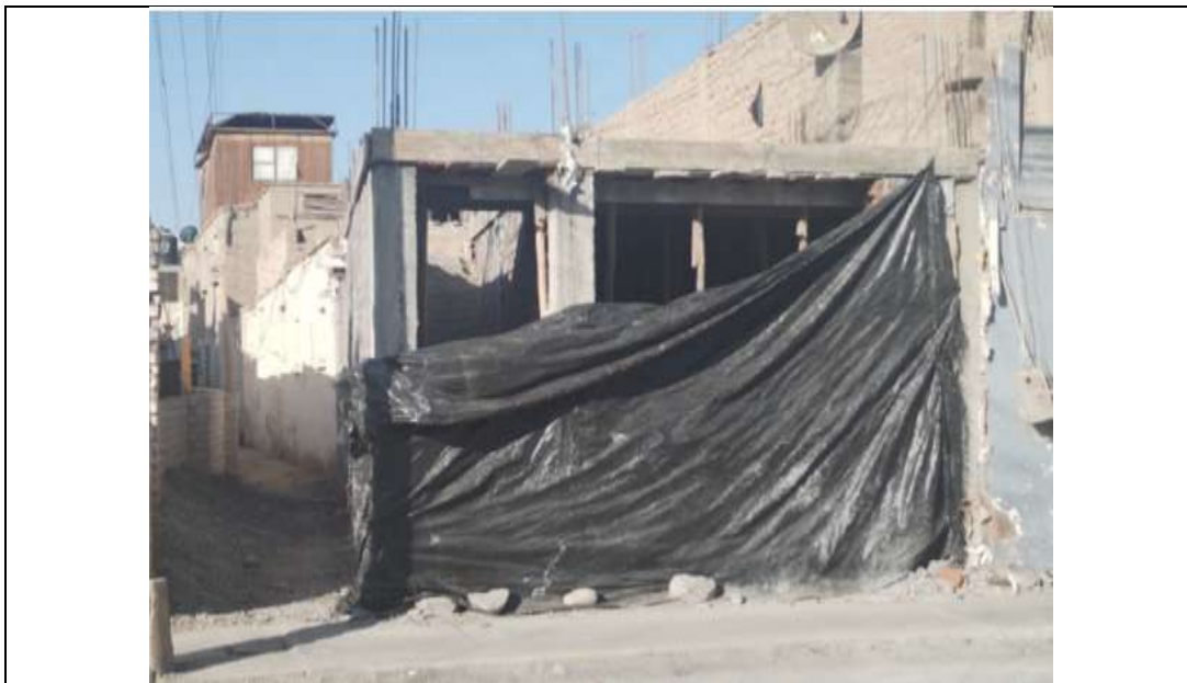
FUENTE: Inspección ocular de fecha 14/06/2023.
