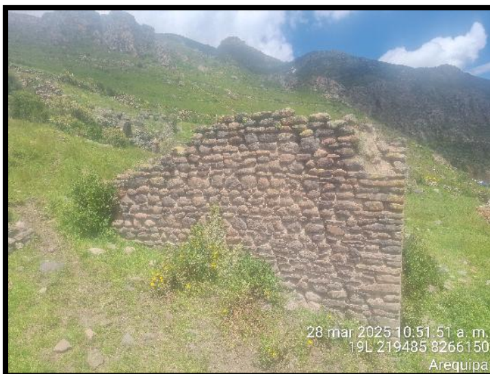
Foto N° 01: correspondiente al 28 de marzo del 2025, en el que se visualiza un recinto de planta rectangular en regular estado de conservación.
