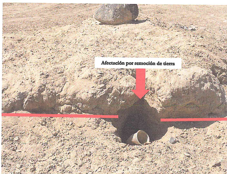
Foto N° 9: Vista a detalle de las bases de muros, aún remanentes, afectados por agentes antrópicos.
