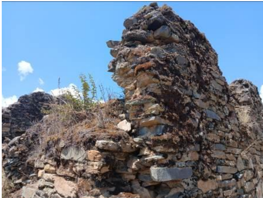
Imagen N° 21: Muro en riesgo de desplome.
