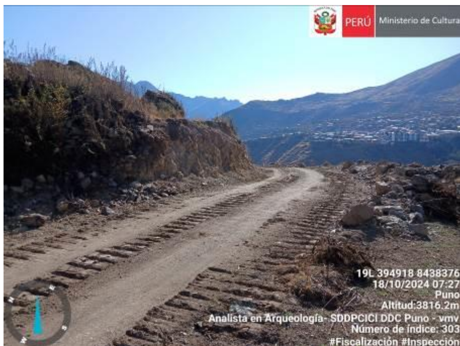
Imagen N° 16: Vista en detalle de apertura de trocha que corta andenes.
