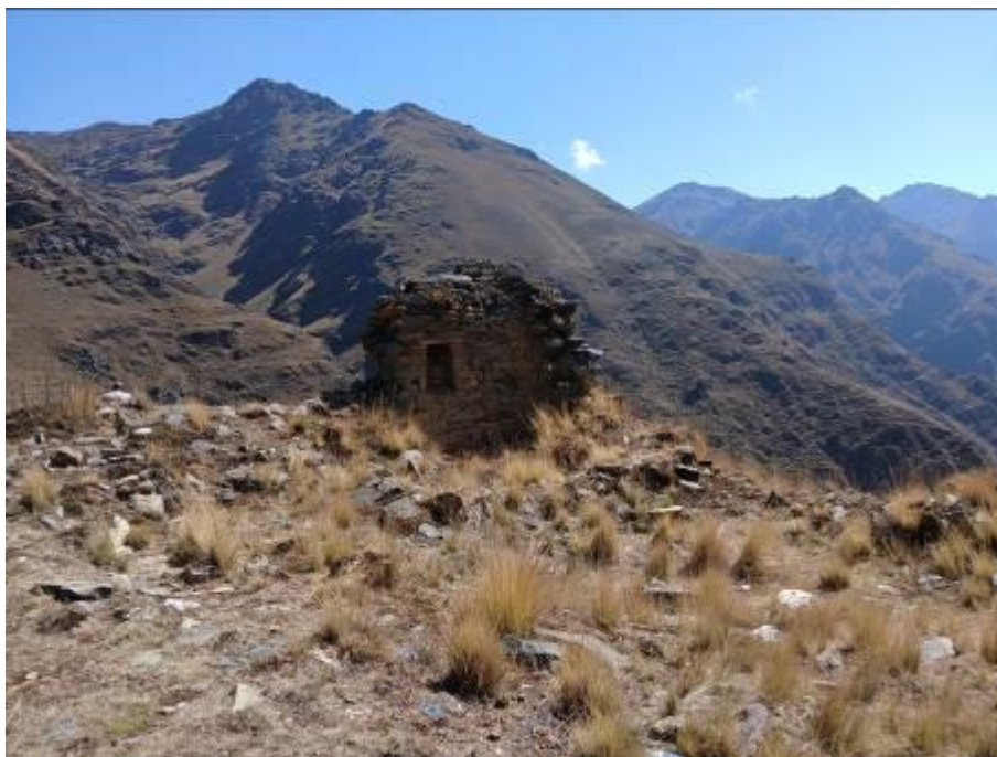
Imagen N° 22: Estructura que requiere apuntalamiento.
