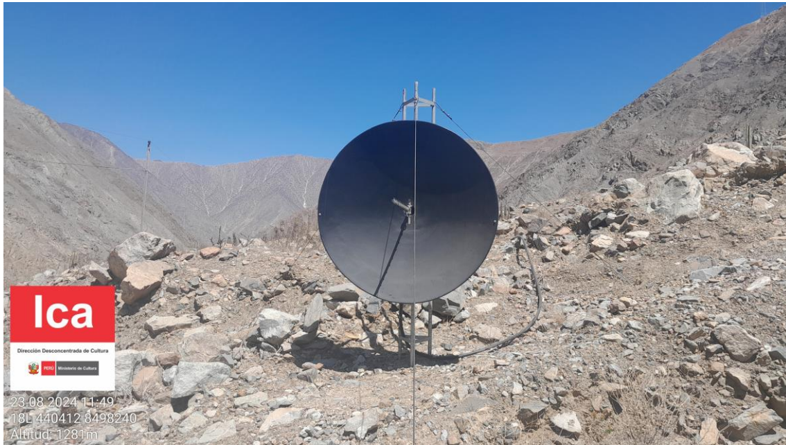
Imagen 03: vista panorámico de la instalación de antena parabólica.
