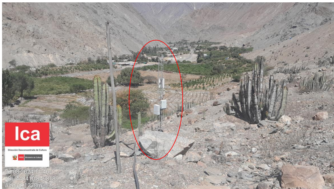
Imagen 02: vista panorámico de la torre metálica como antena telefónica.
