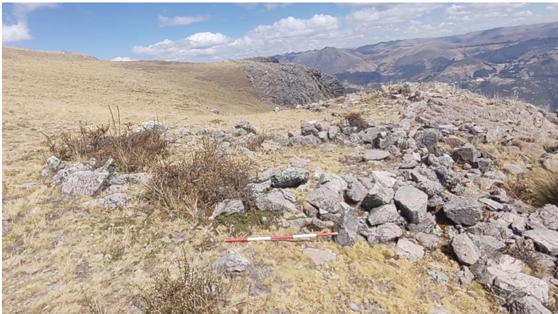
Imagen 06: Estructuras circulares registradas en la cima del cerro de Anahuarccce. Nótase el colapso parcial de sus muros.
