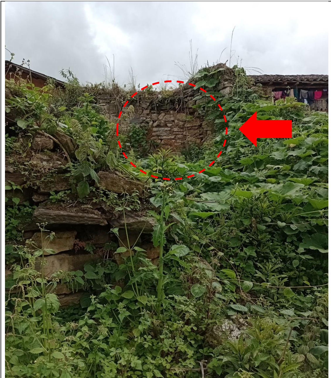
Vista de la casa redonda donde se puede evidenciar enlucido al interior, y el estado actual de la infraestructura.
