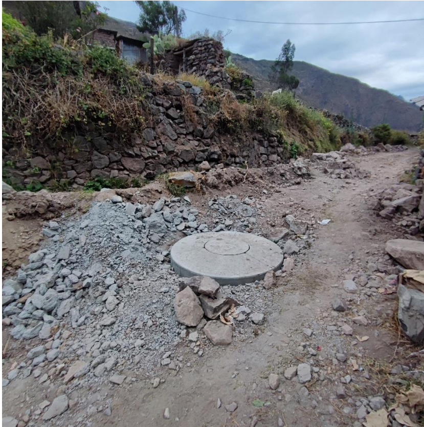
Sitio Arqueológico Gorgorjirca. Nótese la instalación de un buzón para desagüe ubicado en la trocha que funciona como vía de acceso colindante al Bien Inmueble Prehispánico ubicado en la parte superior de la imagen.
