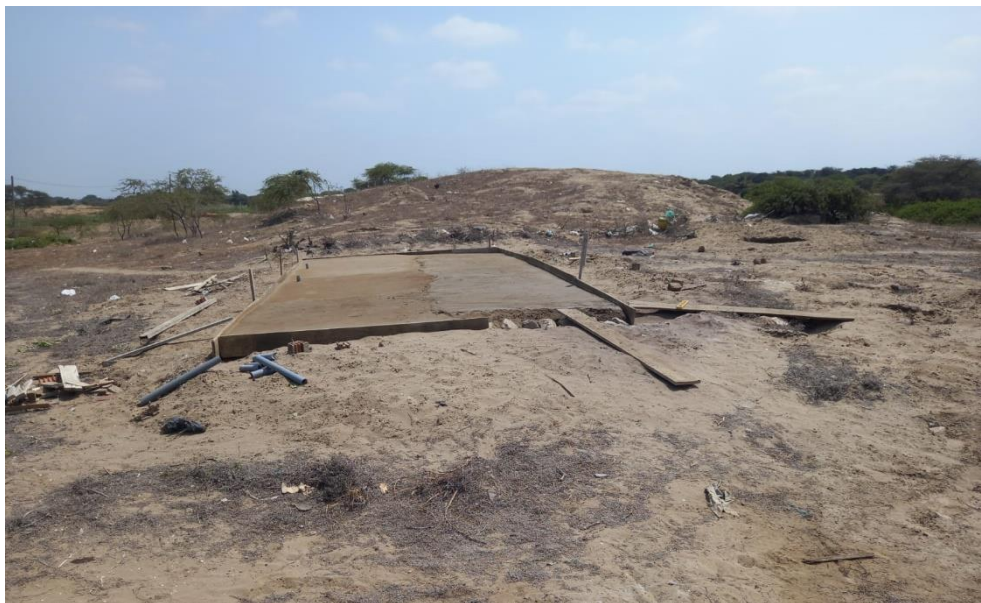
IMAGEN 9. Vista de una plataforma o loza de concreto al momento que estaba siendo construida, afectando el sitio arqueológico, al lado sur del montículo 2 o central.
