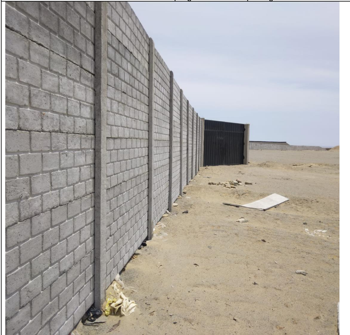
Muro de material prefabricado de concreto y portón negro de metal dentro del sitio arqueológico Huaca Colorada, registro de la inspección de fecha 21 de febrero de 2024
