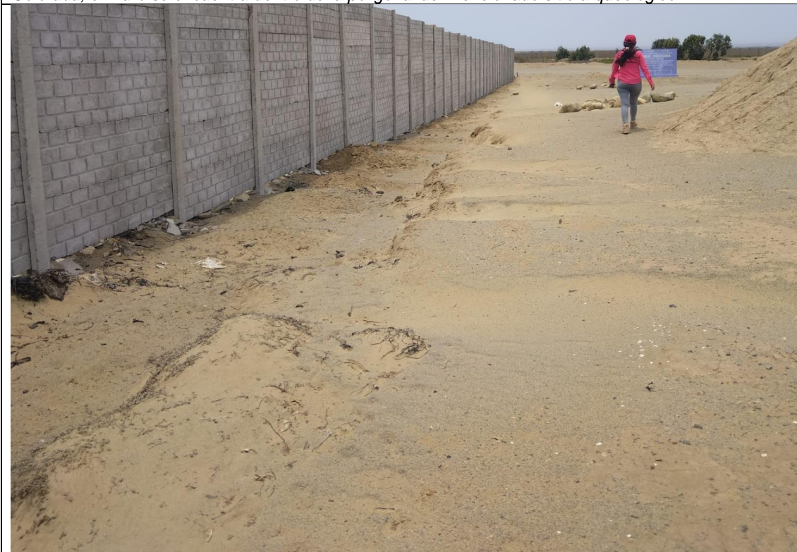
Vista de muro de material prefabricado correspondiente a la afectación constatada en el sitio arqueológico Huaca Colorada, el muro se encuentra dentro de la poligonal del mencionado sitio, registro de la inspección de fecha 21 de febrero de 2024.
