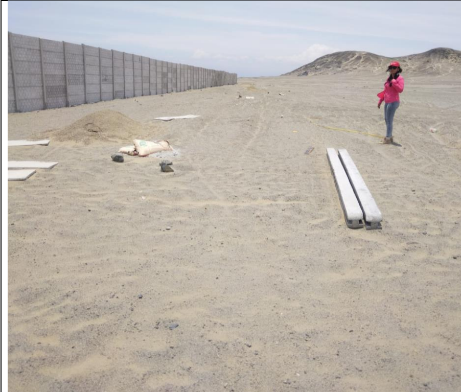
Muro de material prefabricado nótese las columnas de concreto prefabricado dentro del sitio arqueológico Huaca Colorada, así como empleo de cemento para los cimientos de las columnas registro de la inspección de fecha 21 de febrero de 2024.
