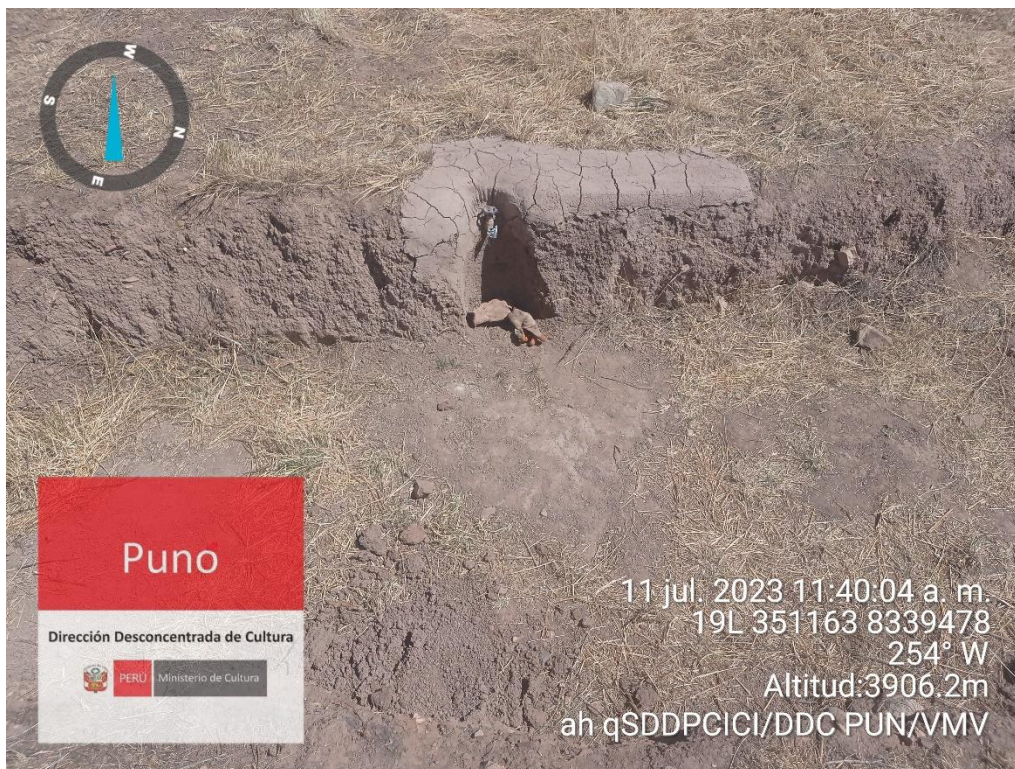
Imagen N° 23: Detalle de uso inadecuado del monumento (bebedero de ganado), ya que ha sido usado como corral la cima del monumento (sector A).
