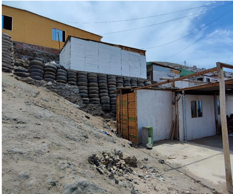
Nivelación y construcción de plataformas moderna para el asentamiento de estructuras precarias.
