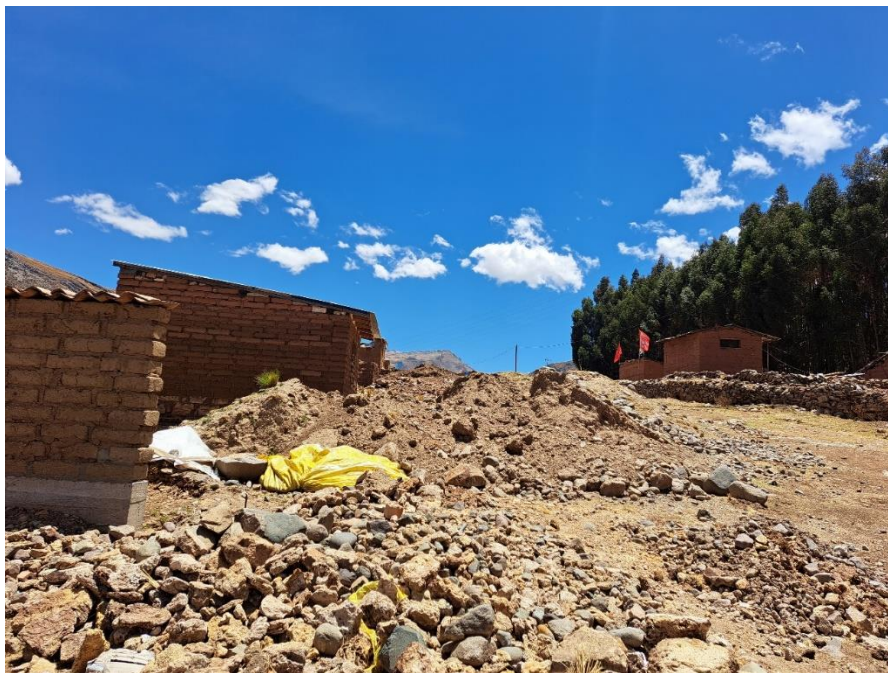
Imagen 10. Construcción de viviendas en parte del polígono y arrojo de desmontes sobre la calzada del Camino Prehispánico (Vista E-O).
