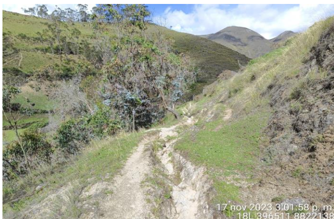
Imagen 01. Vista de una sección del segmento de camino de Chipa. Nótese calzada despejada afectada por lluvias de temporada .
