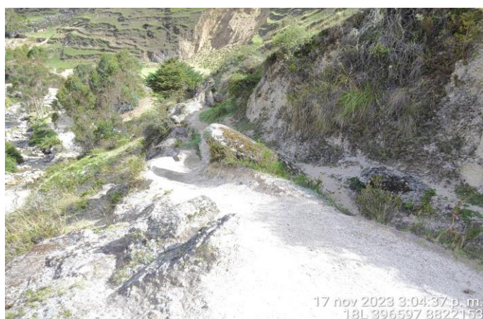
Imagen 02. Vista de una sección del segmento de camino de Chipa. Nótese calzada despejada afectada por lluvias de temporada
