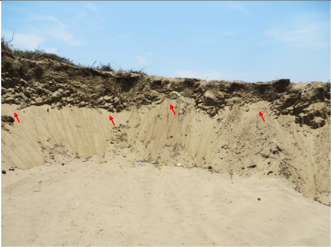
Imagen 12: Perfil del socavón en proceso de erosión.
