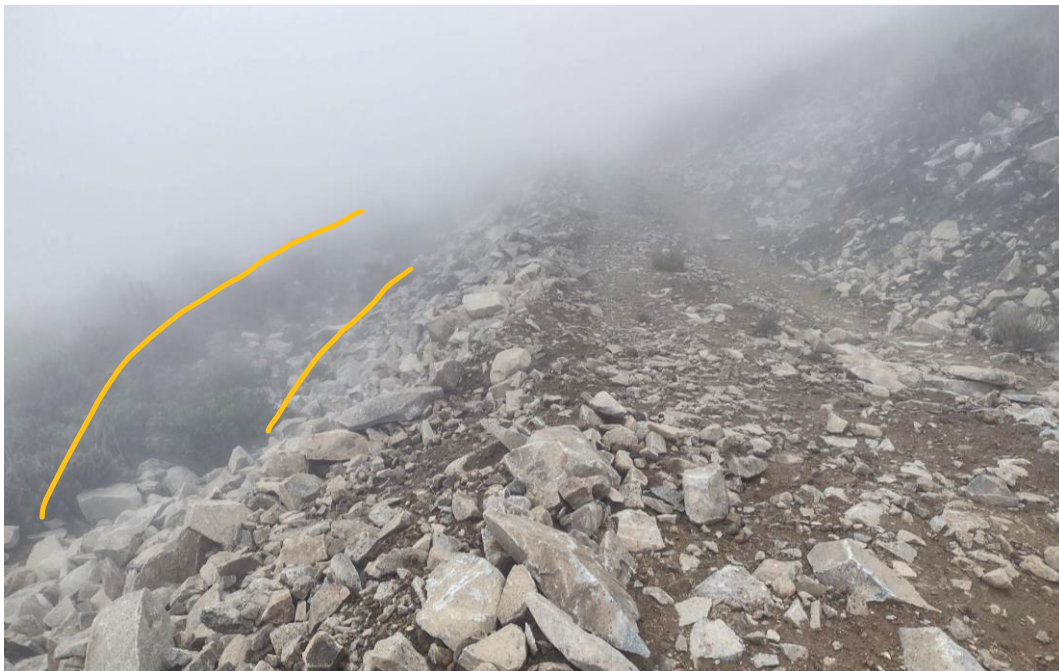
Foto 2: Trocha carrozable en proceso de habilitación, con la plataforma intransitable con vehículos ligeros. A un costado se observa el trazo del camino de ganaderos.
