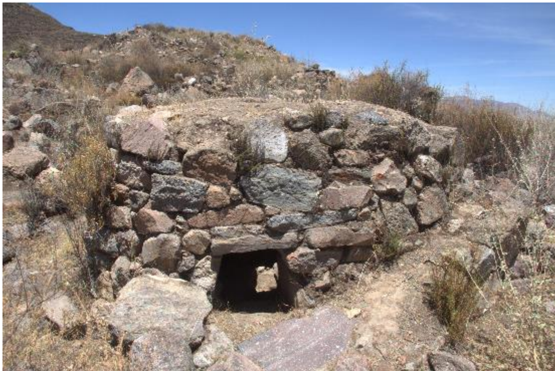
Imagen 10: Estructura funeraria en regular estado de conservación. Presenta deterioro en el techo.
