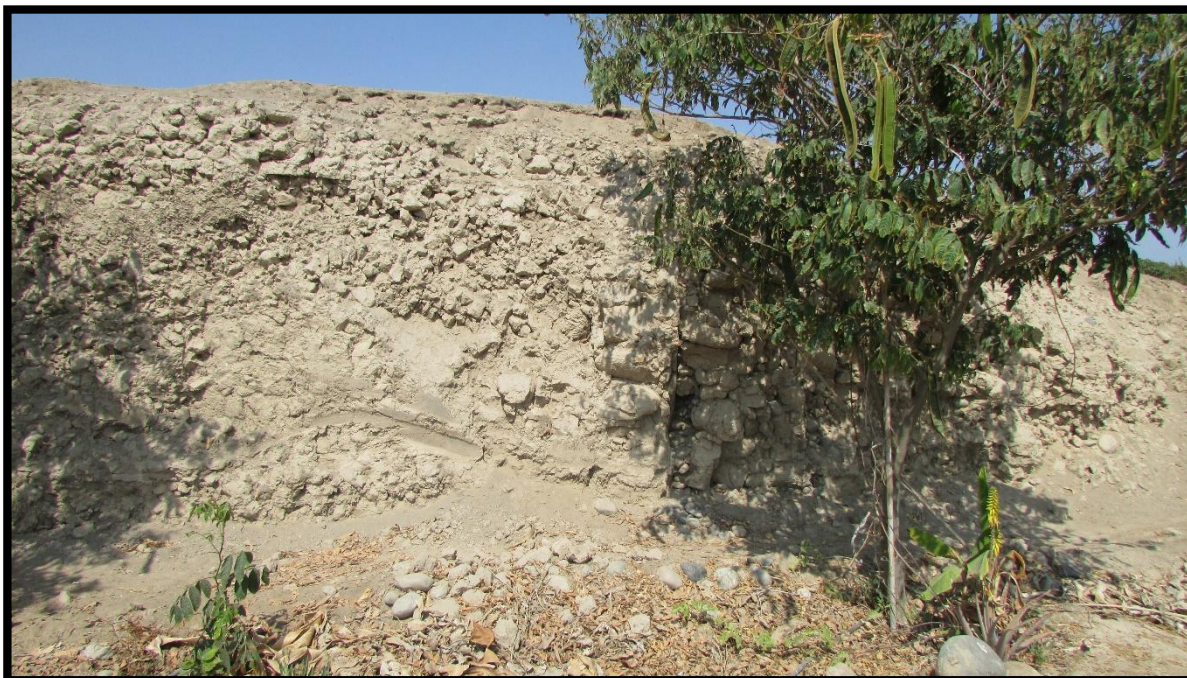
Figura 10. Muros afectados por el sembrado de un árbol de pacaë.
