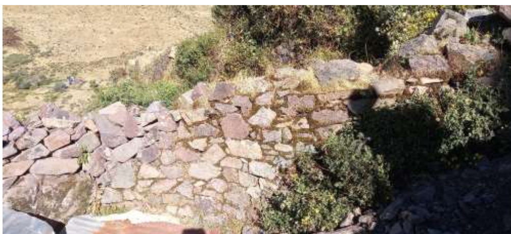
Foto 04: vista de la estructura de piedra reconstruída sin autorización, empleando concreto para asegurar los materiales constructivos.
