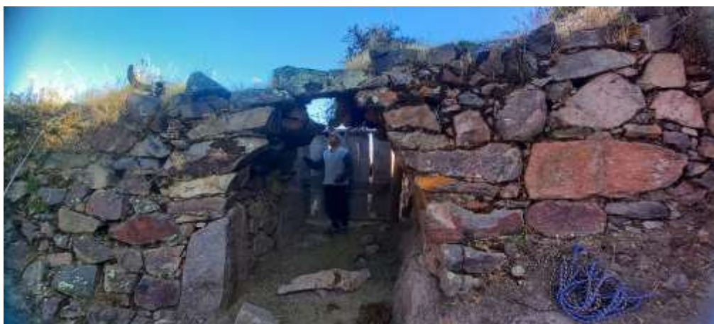
Foto 05: vista de la estructura de piedra reconstruída sin autorización, empleando concreto para asegurar los materiales constructivos y colocando puertas para usarlo como corral de toros.
