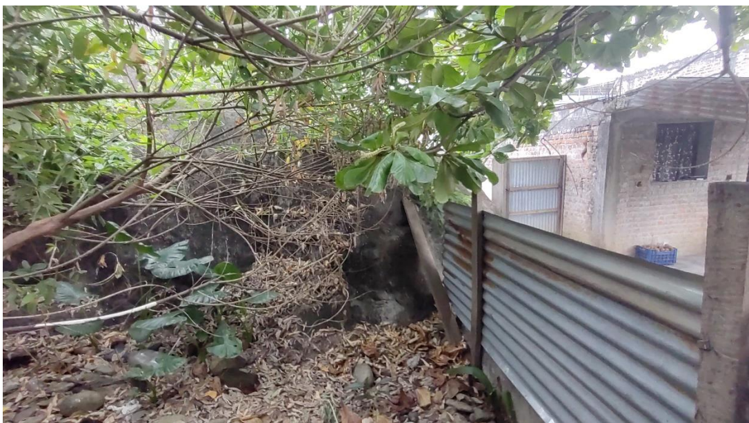
Imagen 08: Afectación del lado sur y superficie superior de la evidencia pétrea debido a la presencia de árboles frutales y otras. Nótese parte de la vivienda continua a ella.
