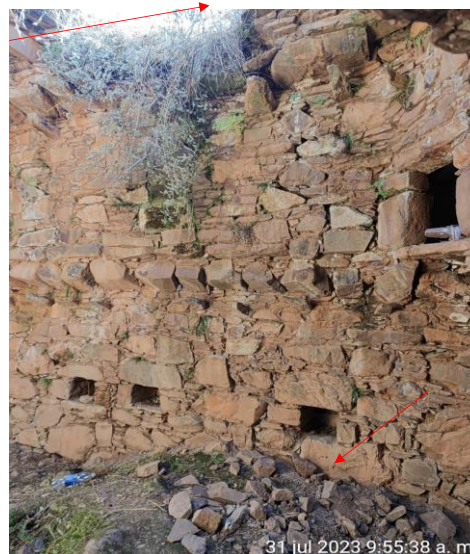
Imagen 03. Vista del interior de la estructura denominada "La Capilla", nótese desprendimiento de material pétreo producto del inadecuado deshierbe realizado.
