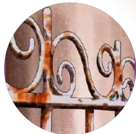
1. Oxidación en rejas de metal
